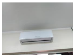
01 Ar condicionado de 30.000 BTUS
