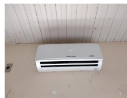
04 aparelhos de Ar Condicionado 12.000 BTUS
